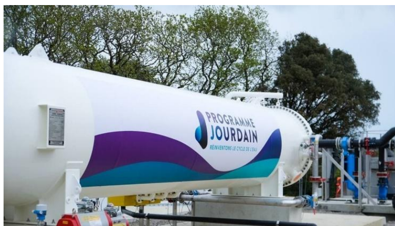
FIGURE 7: Photographie de la cuve de traitement test pour le projet Jourdain (Source : Site internet de France 3 Pays de la Loire, 2025)
